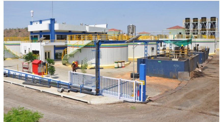
Die Biogasanlage im fertigen Betrieb
